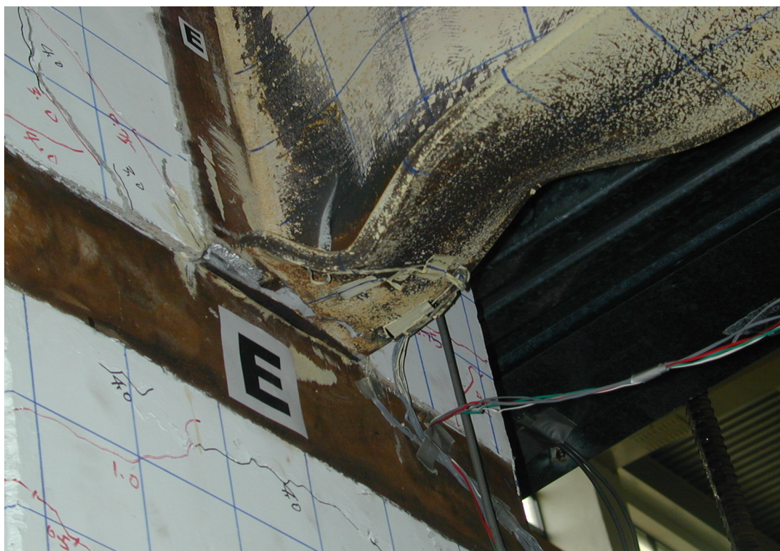
照片二 顯示因扭轉挫屈而造成鋼梁下翼板斷裂
